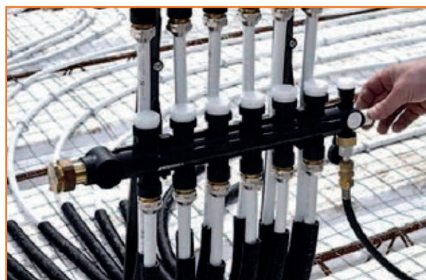
5 Mise en pression de l'installation à plus de 3 bars. Pose du ferrailage complémentaire et coulage de la dalle de compression.
