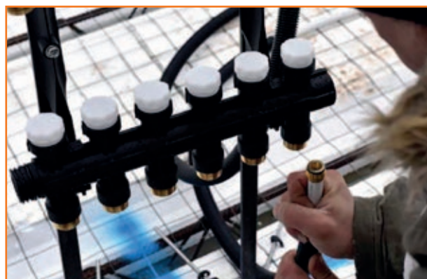
4 Raccordement des tubes au collecteur.
