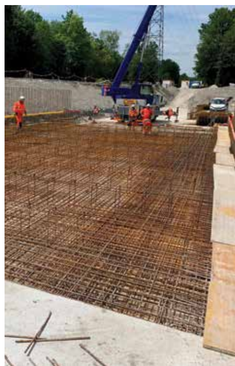
Bassin rétention, autoroute A48, GRENOBLE, 2021
