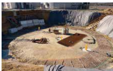
Station d'épuration, GARDONNENQUE, 2022
