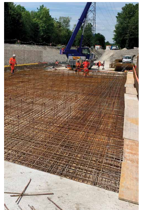
Bassin rétention, autoroute A48, GRENOBLE, 2021
