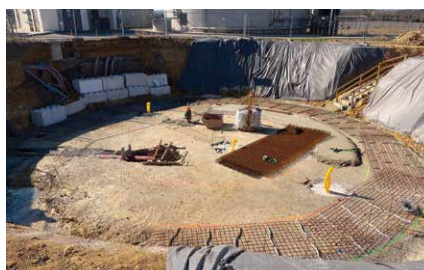
Station d'épuration, GARDONNENQUE, 2022
